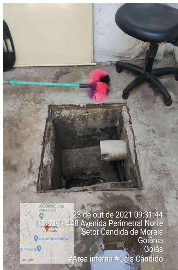
Figura 11 - Ausência de Tampas de Concreto em Diversas Unidades.
