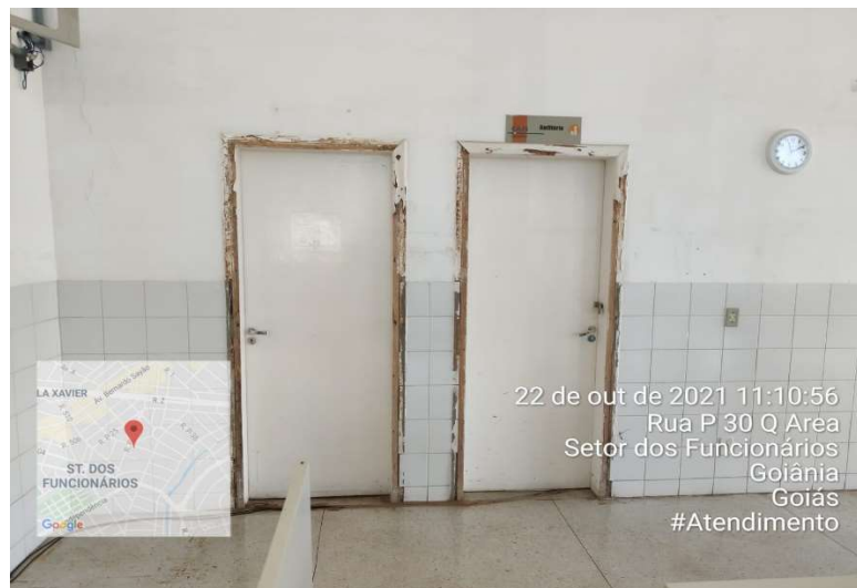
Figura 3 - Esquadrias de Madeira necessitando de substituições parciais, tratamento com massa e pintura e recomposição de alisares e aduelas.
