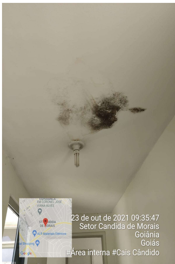
Figura 1 – Patologia de Infiltração em Telhados, demandando correção em telhas de fibrocimento e pintura.
