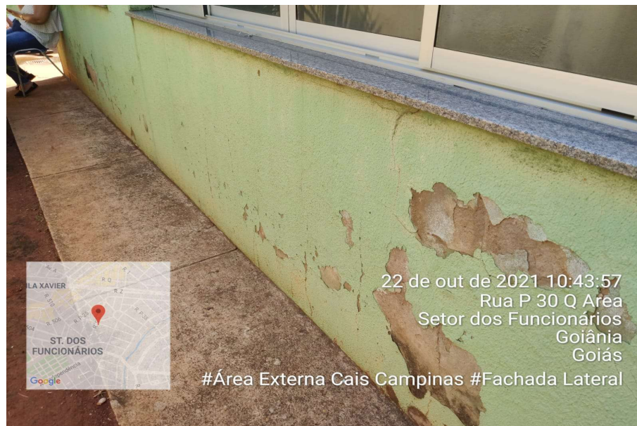
Figura 5 - Pintura Externa danificada, sendo necessária remoção da pintura existente, aplicação de massa acrílica e repintura.
