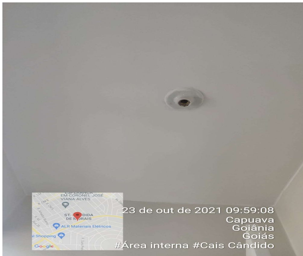
Figura 9- Ausência de Lâmpadas ou Luminárias em diversos ambientes das unidades.
