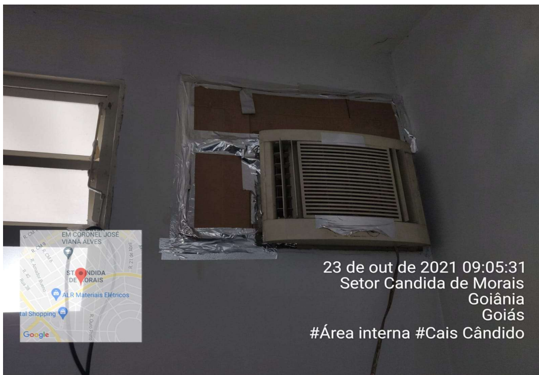
Figura 13 - Diversas Esquadrias Necessitando de Reparos e Ajustes
