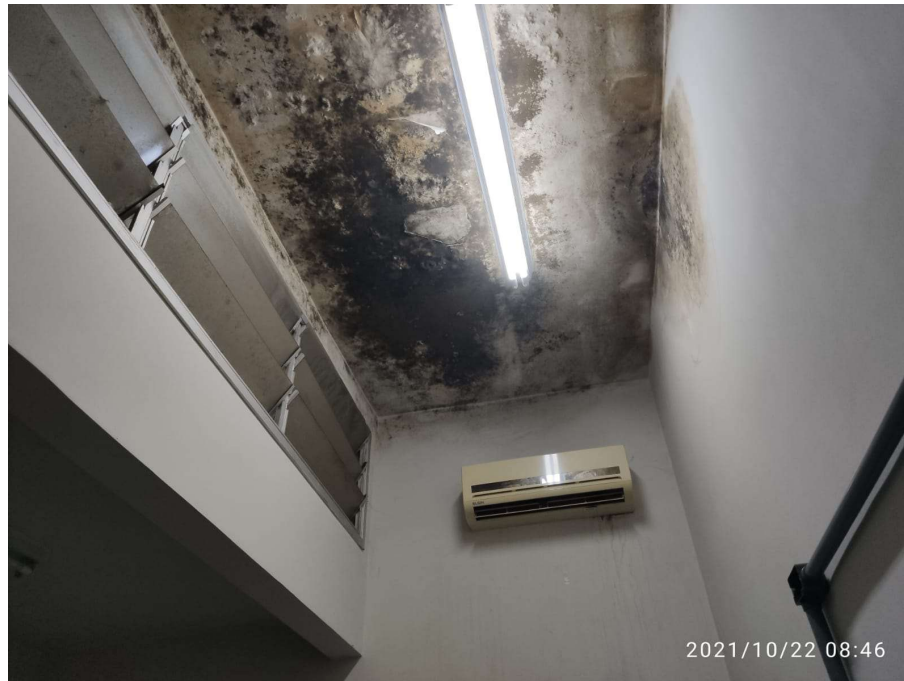
Figura 10 - Graves infiltrações em Lajes de Concreto ou em Coberturas de Fibrocimento.
