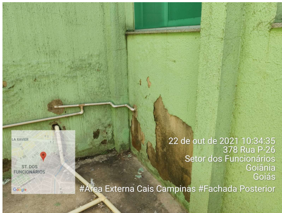
Figura 7- Presença de Trincas e Fissuras gerais nas áreas externas e internas das unidades.
