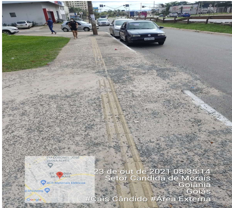
Figura 14 - Falha em Pisos de Concreto com resistência insuficiente, necessitando de recomposição integral.
