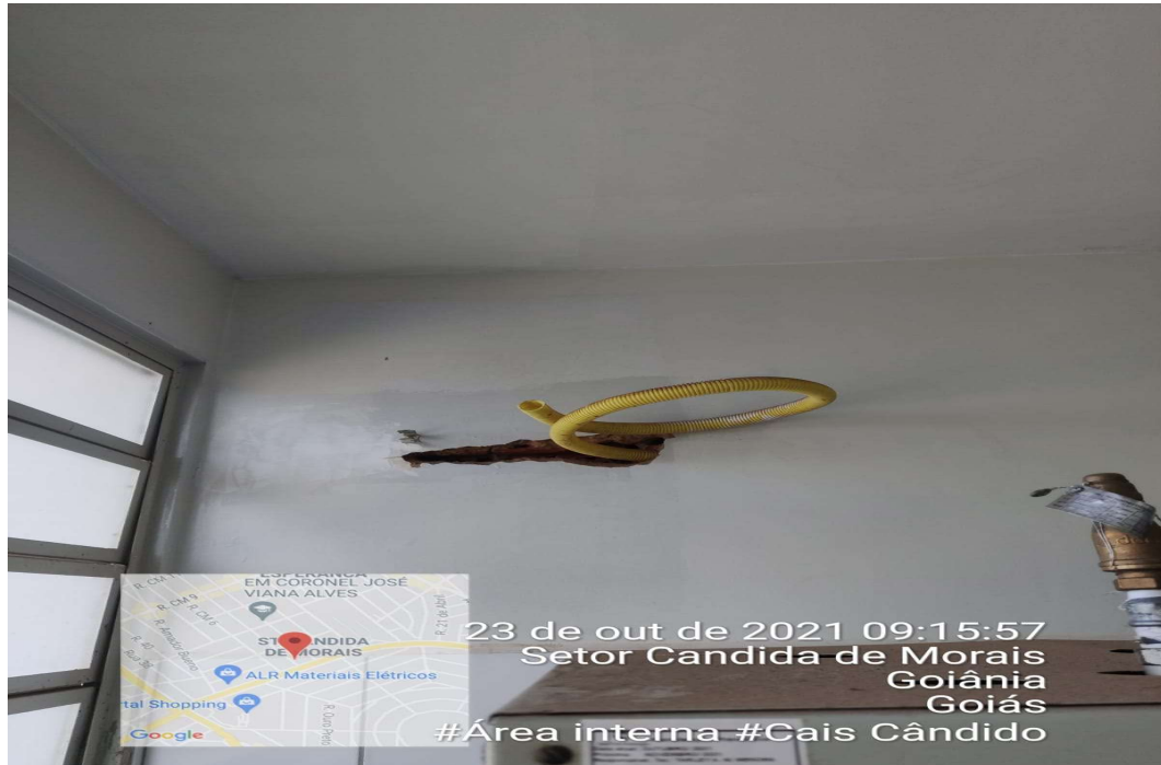
Figura 12- Necessidade de Recomposição de Reboco e Eletrodutos Expostos
