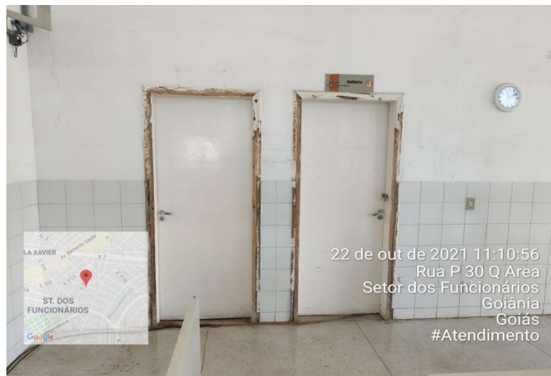
Figura 3 - Esquadrias de Madeira necessitando de substituições parciais, tratamento com massa e pintura e recomposição de alisares e aduelas.
