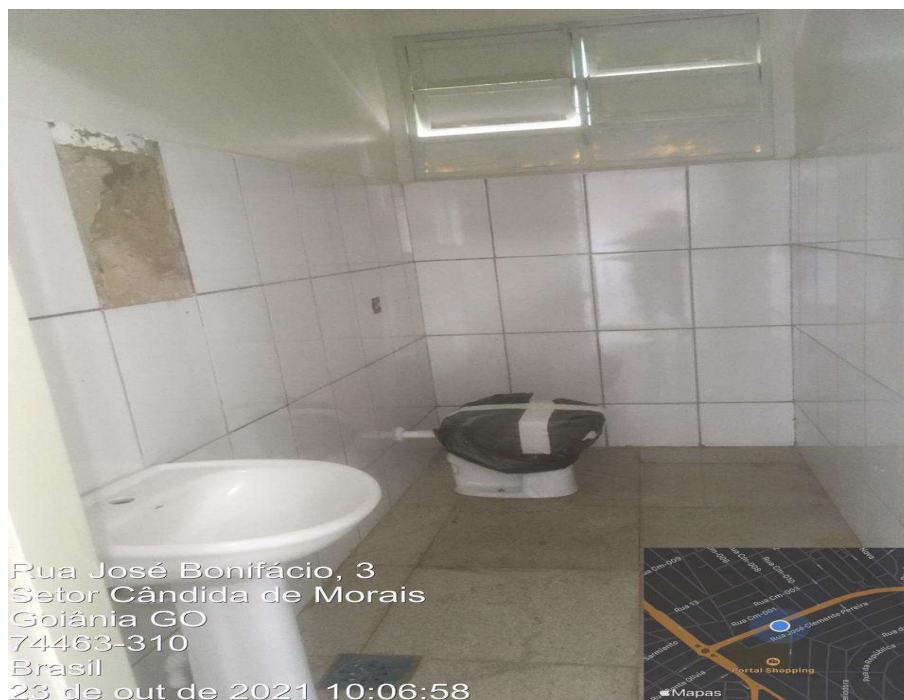
Figura 15 - Falha em Revestimentos de Parede e Banheiros Desativados Por Ausência de Manutenção
