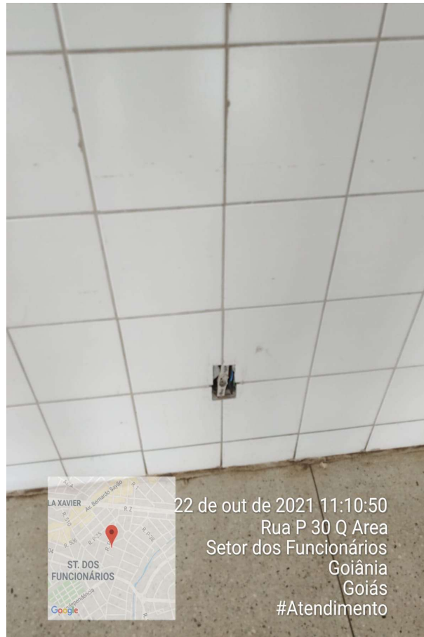
Figura 4 - Ponto de Tomada sem Acabamento, sendo necessária instalação, ou em alguns casos, substituição do conjunto de suporte, módulo e placa.
