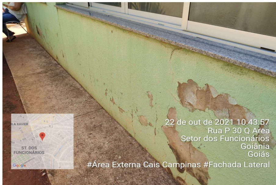
Figura 5 - Pintura Externa danificada, sendo necessária remoção da pintura existente, aplicação de massa acrílica e repintura.
