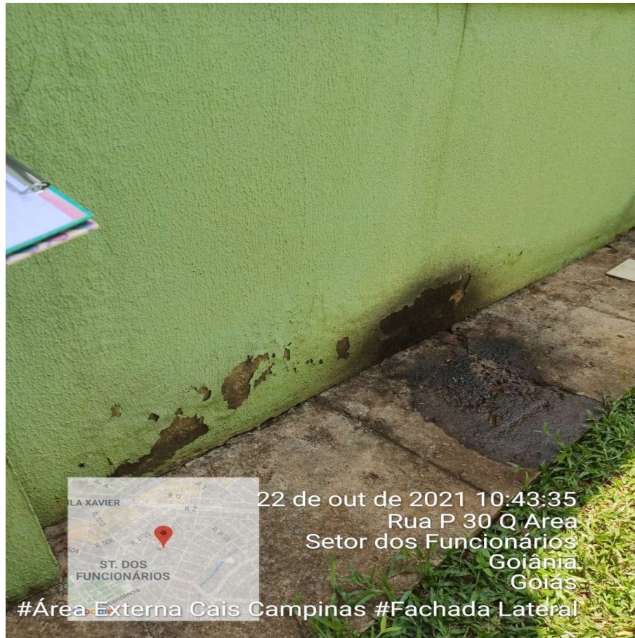
Figura 6 - Falhas decorrentes da ausência de impermeabilização próxima ao solo, sendo necessária aplicação de 40 centímetros ou mais de altura de produtos impermeabilizantes.
